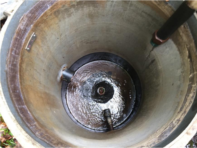
Quelle Nr. 8: WV Mülihole 1, Einlauf 04
