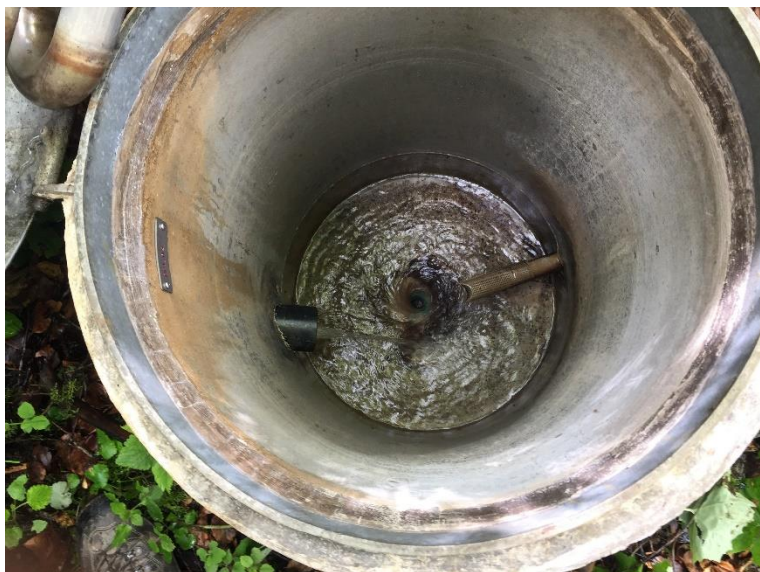
Quelle Nr. 9: WV Mülihole 1, Einlauf 05
